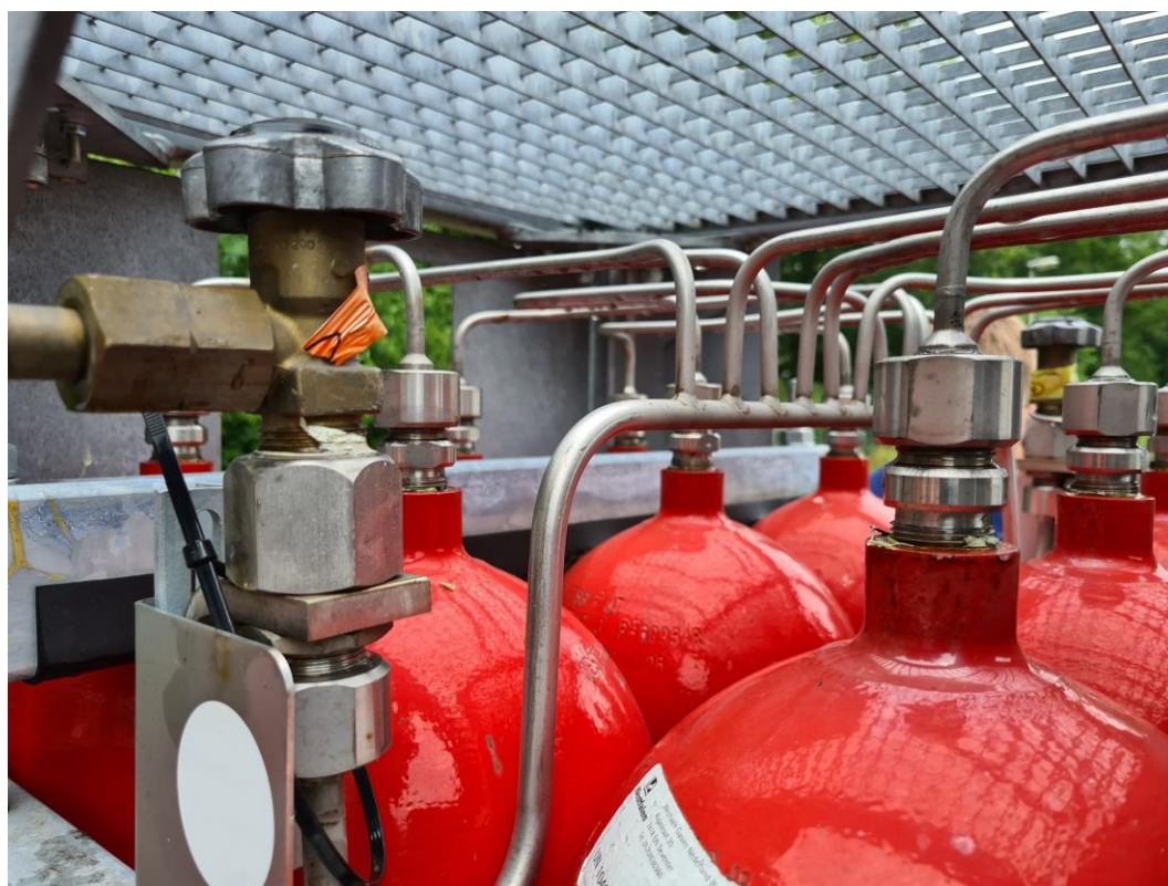
Figuur A – De leidingen tussen de gasflessen en het centrale aansluitpunt. Foto: NIPV.
